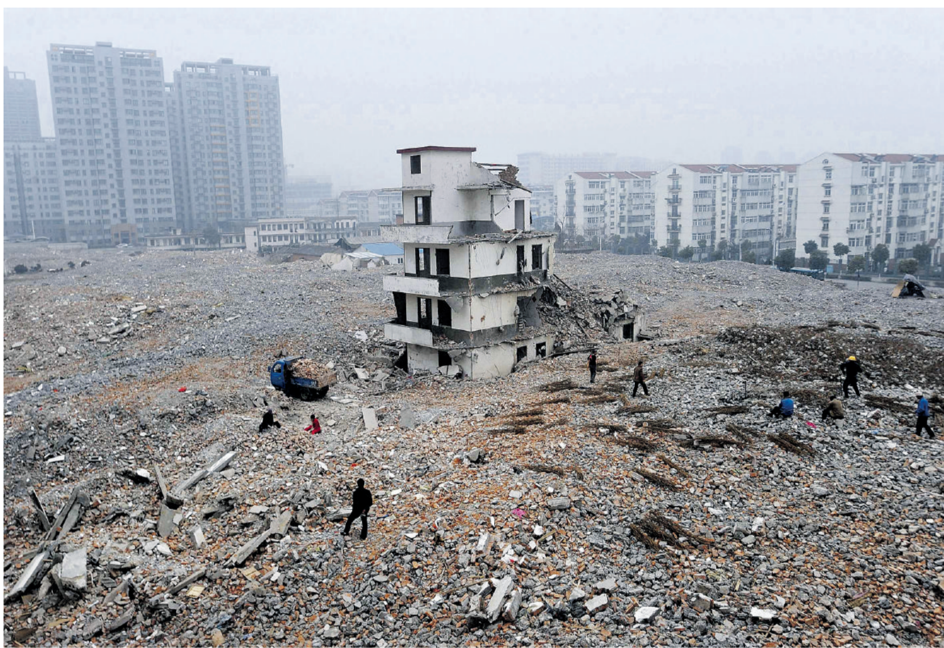
Een laatste huis staat nog overeind op een bouwterrein waar binnen niet al te lange tijd nieuwbouw zal verrijzen.
